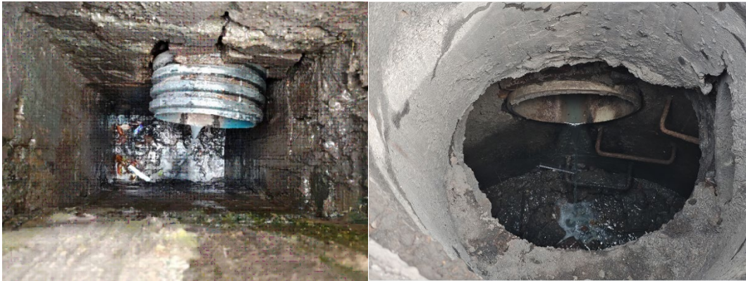
图 3.40 雨水口、雨水井陶瓷废水混接
