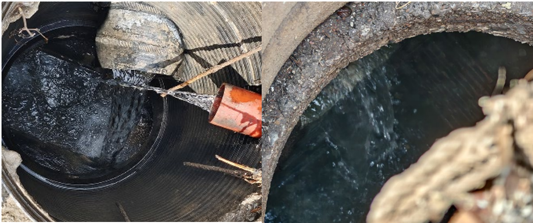
图 3.41 污水井清水混接
